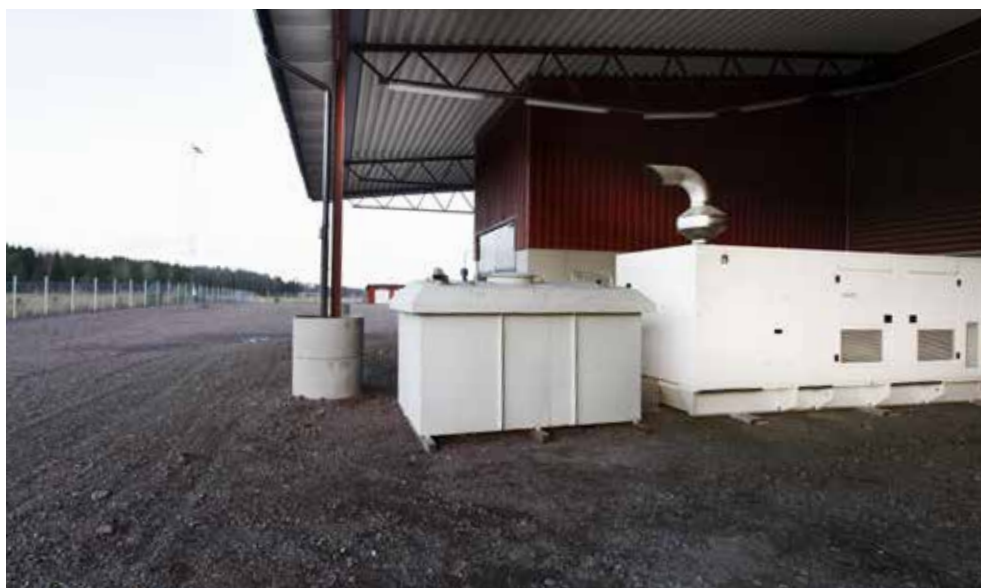
Bild 17. Reservkraft dieselaggregat placerat utomhus. Placering av tank förenklar påfyllning av bränsle.
