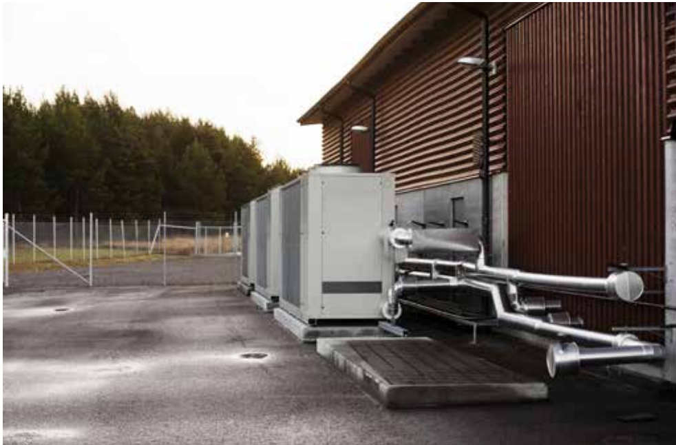
Bild 12. Frikyla placerad utomhus för att nyttja utomhusluft.
