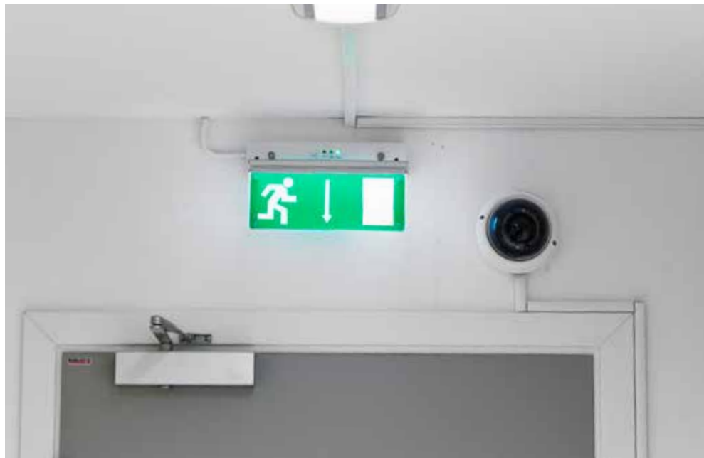
Bild 4. Kameraövervakad in- och utpassering vid ett it-utrymme
