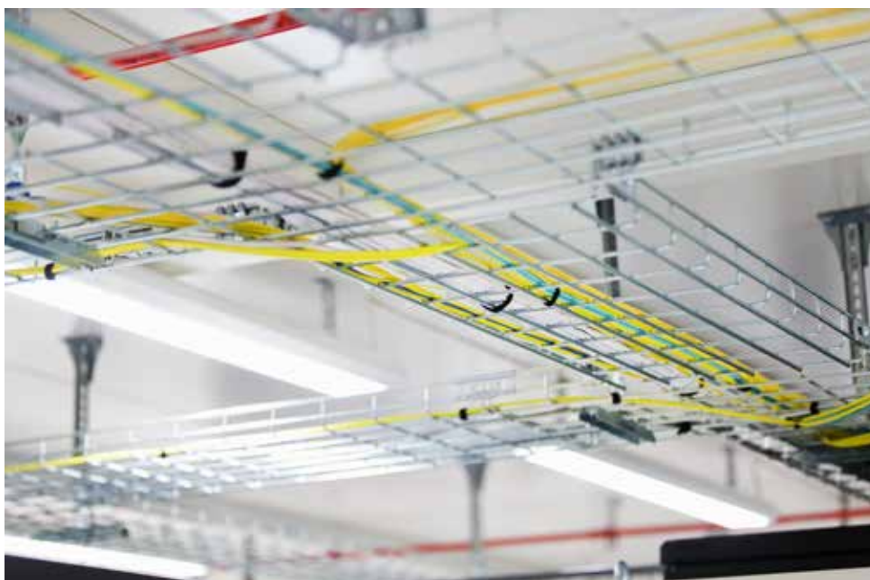
Bild 20. Kabelstegar monterade i tak.
