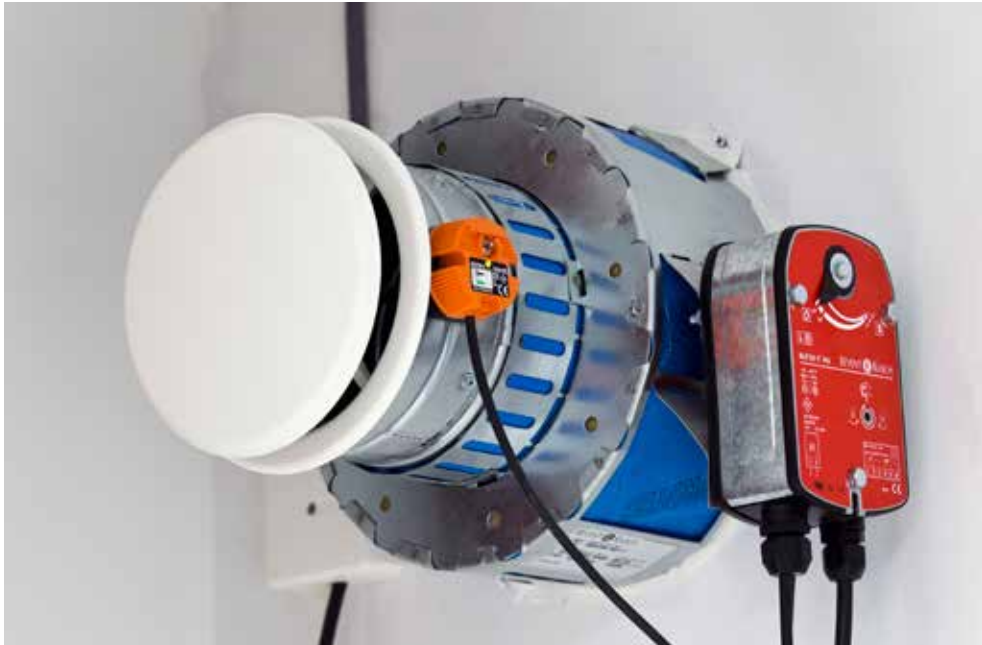
Bild 10. Brandspjäll anslutet till brandlarm monterat på en ventilationskanal.
